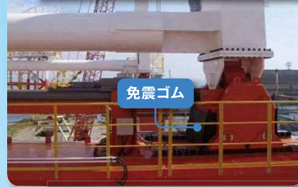
ガントリークレーン免震装置
